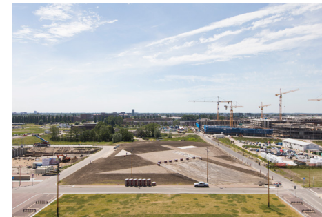
Het Berlijnplein in 2017, aan het begin van de bouw credit: Juri Hiesch
